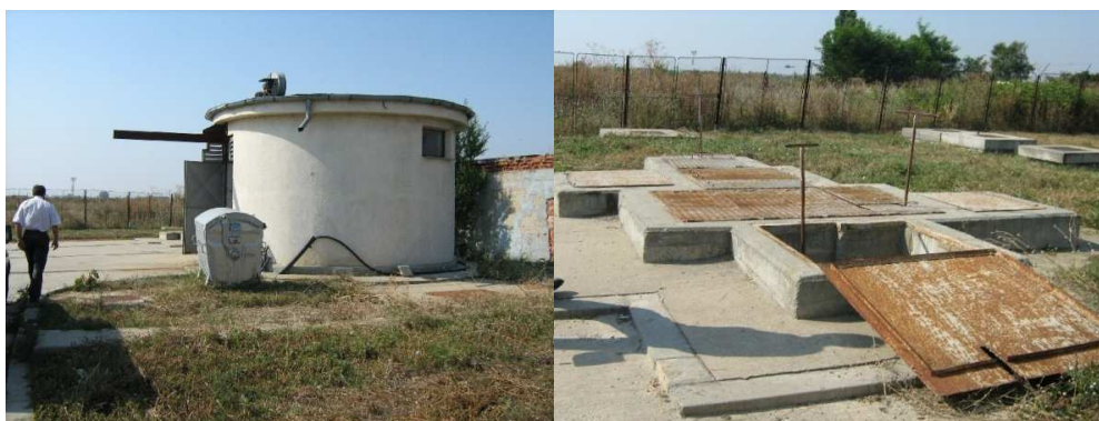
Fig. 23 Principala stație de pompare a apelor reziduale
